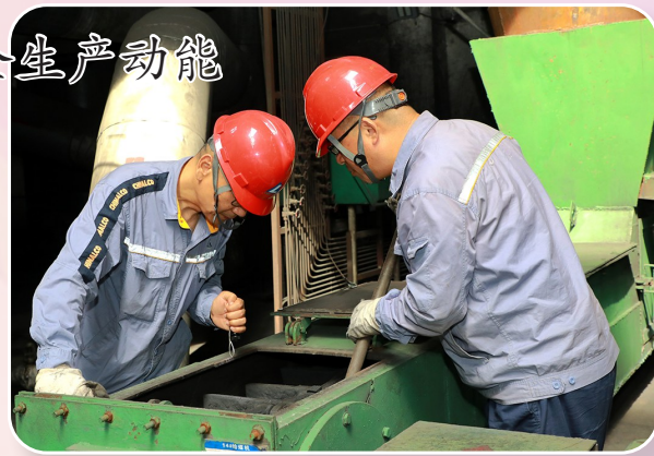
图为中州铝业员工处理锅炉设备故障。申三中 摄
